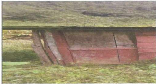
La puerta actual de los baños.
